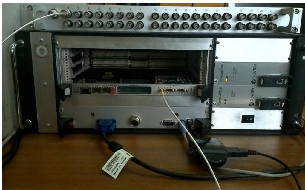
Рис. 5.3 Фото СЭВМ с установленной базовой платой FMC116V.
